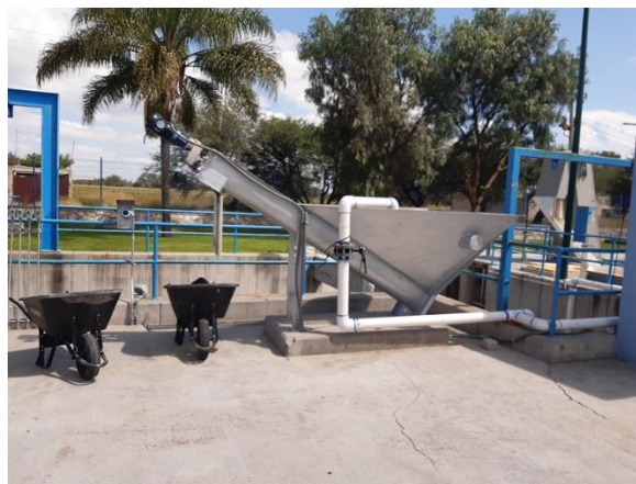
Lavador de Arena Rehabilitado
